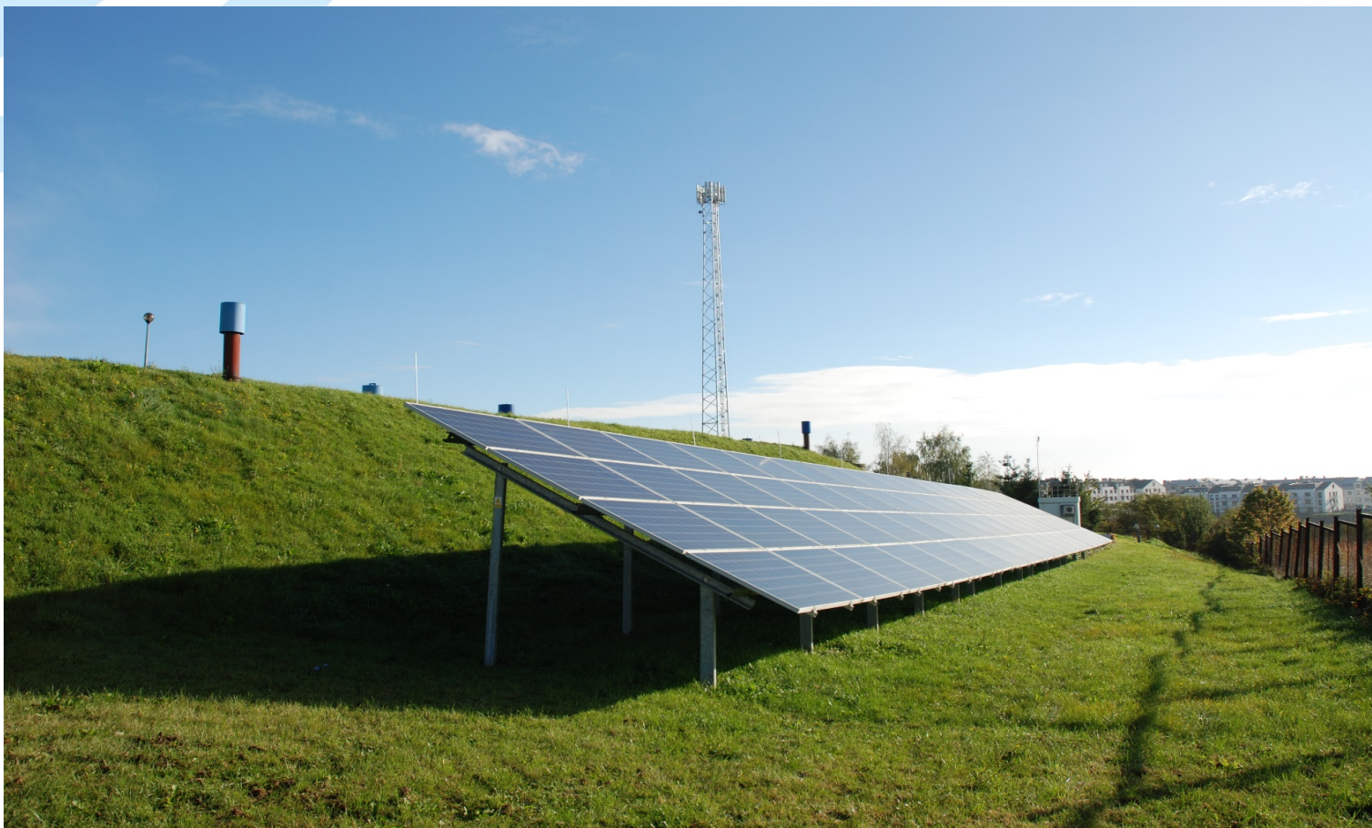
Instalacja fotowoltaiczna w PW Łączna
