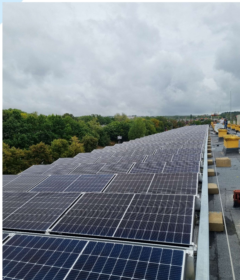
Instalacja fotowoltaiczna na dachu budynku dyrekcji przy ul. Golisza
