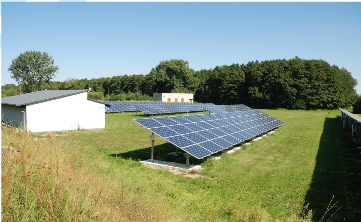
Instalacja fotowoltaiczna w pompowni P1
